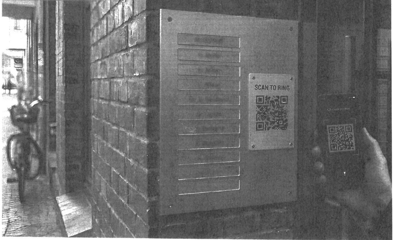
Digitale Zutrittsysteme können den Zugang für Dienstleister aufwandsärmer gestalten. Durch den Scan eines QR-Codes an der Tür startet ein Videoanruf zur Hausverwaltung, die den Zutritt je nach Bedarf regulieren kann
